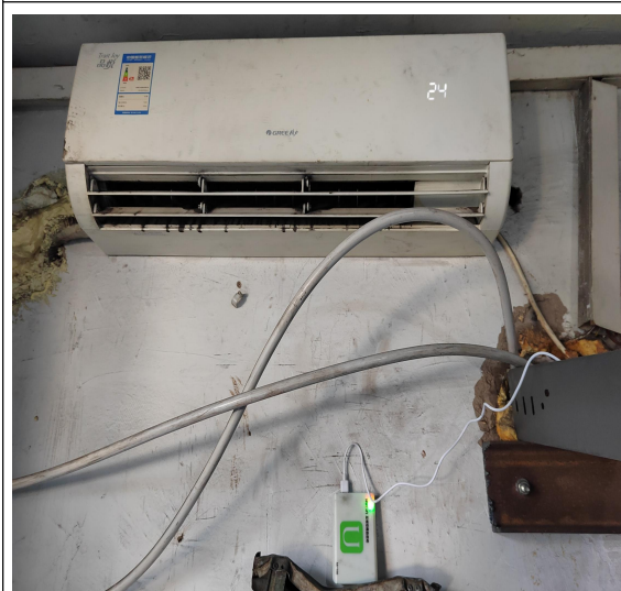
空调及自启装置
