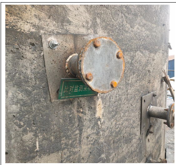
手工监测采样口
