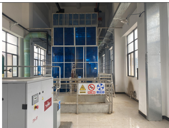
污泥脱水设备
