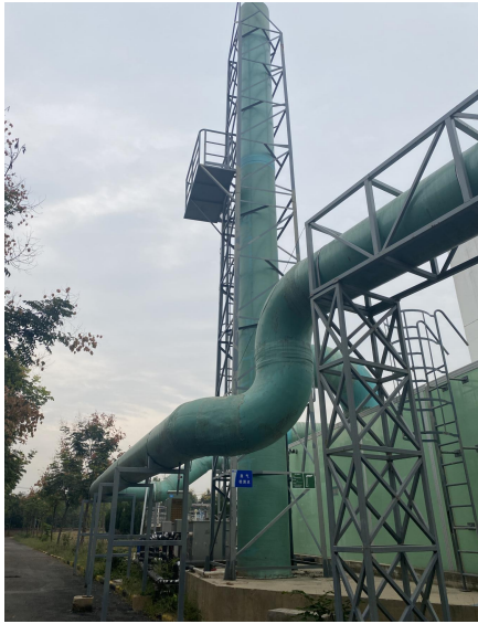
除臭设备排气筒
