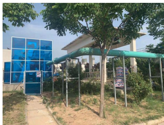
除臭收集系统（生物除臭）
