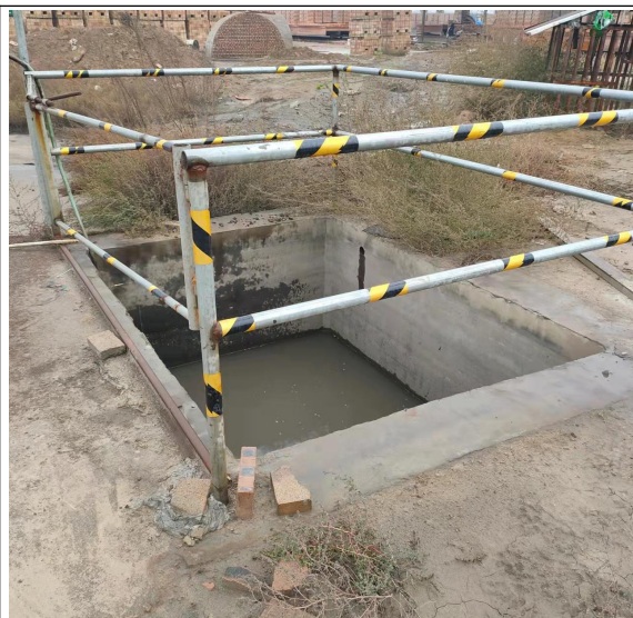
车辆清洗废水沉淀池
