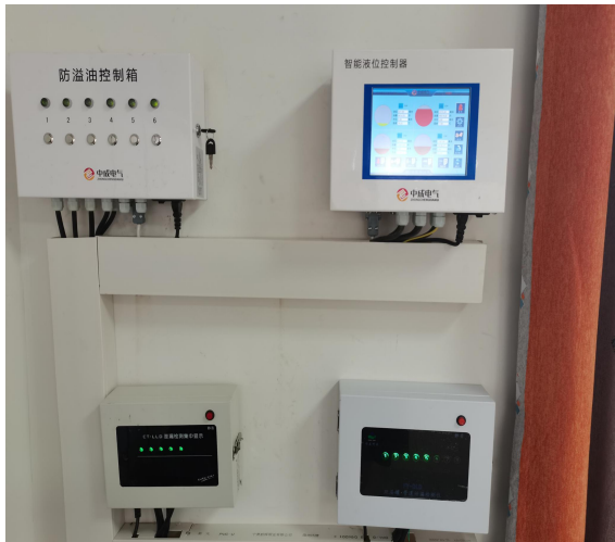
图9 泄漏控制系统
