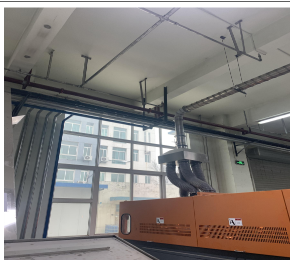
注塑工序废气收集设施
