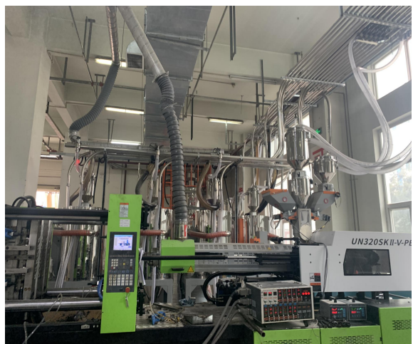
注塑工序废气收集设施
