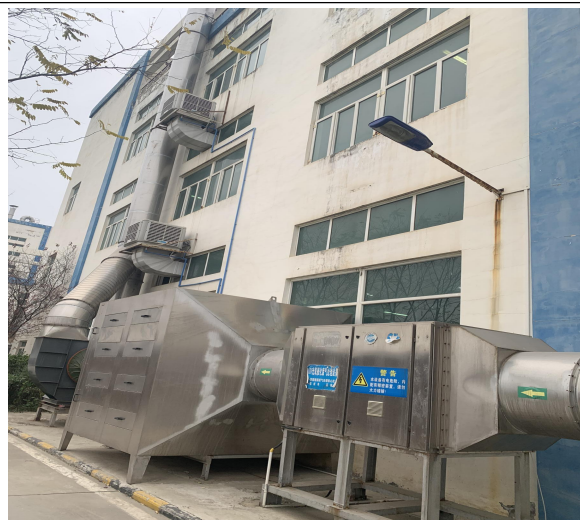
废气治理设施
