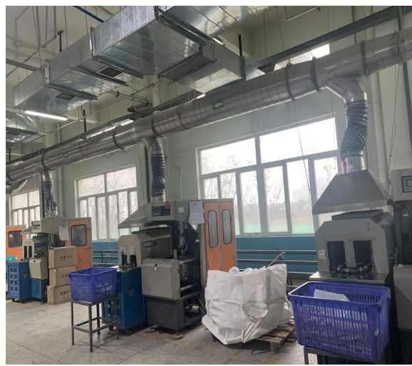
吹瓶工序废气收集设施
