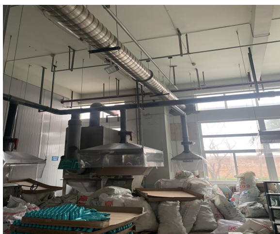
破碎工序集气设施
