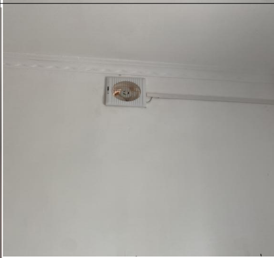
在线监测站房通风设施
