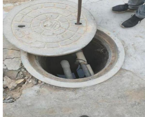
污水处理设备泵
