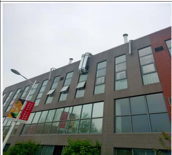
实验室引至楼顶通风管道
