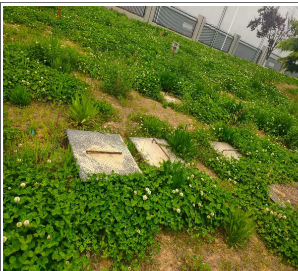
园区污水处理设施
