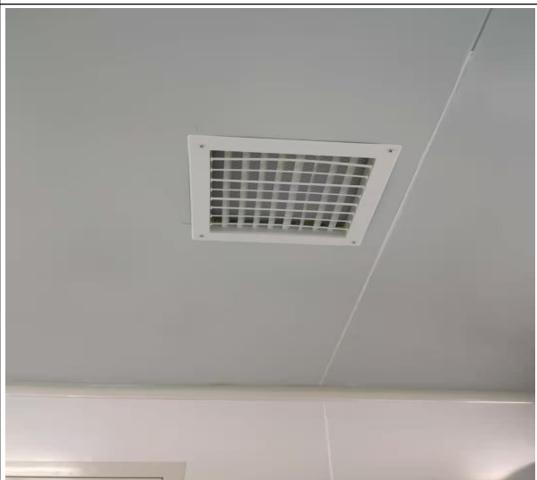
实验室换气排风
