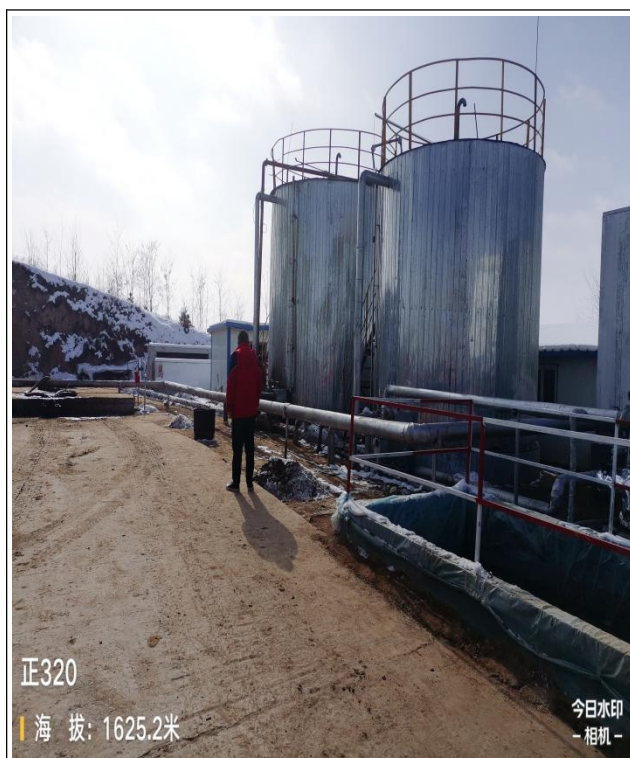
缓冲罐+净化水罐
