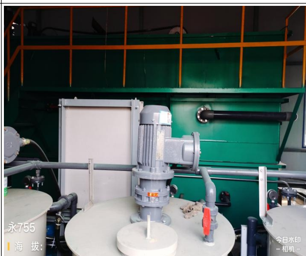
污水处理设施
