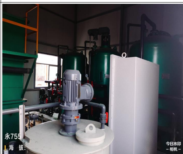
污水处理设施
