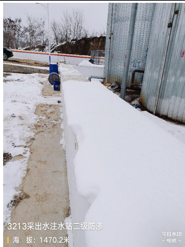
3213 注水站重点防渗
