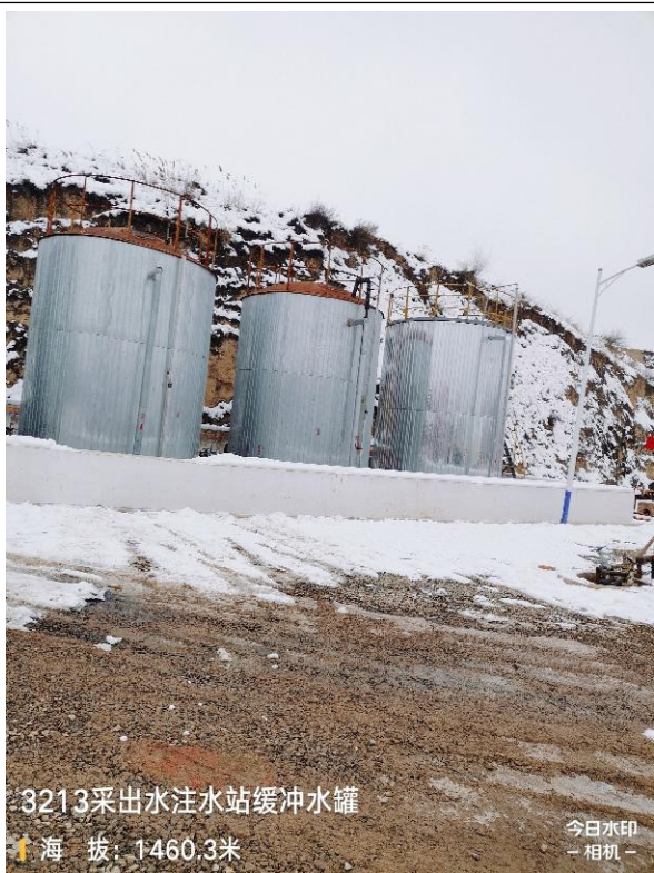
32133 采出水注水站缓冲水罐
