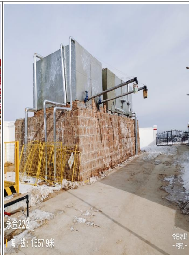
储油罐+清水罐
