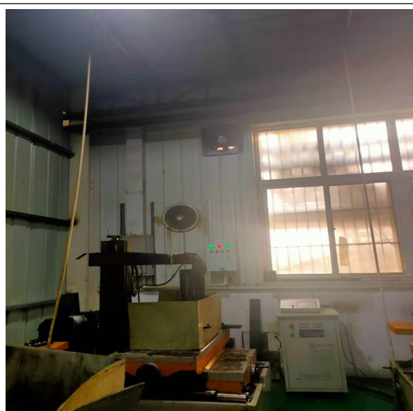
线切割生产区车间内排风扇
