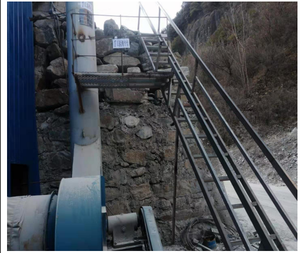
15m 高排气筒
